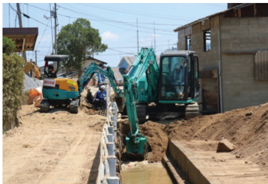
水路土砂撤去状況
