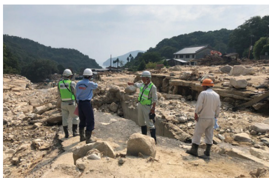
現地確認状況（呉市川尻町）
