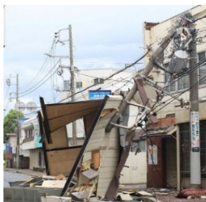
<飛来物による電柱倒壊の事例>
