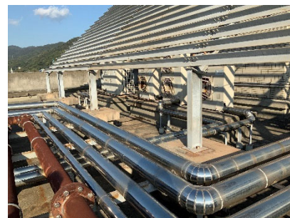
屋上機械設備
