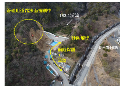
砂防堰堤の整備状況
