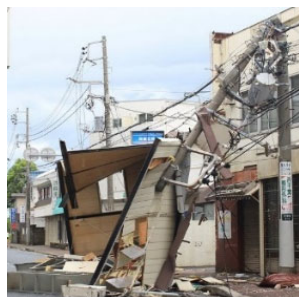
<飛来物による電柱倒壊の事例>
