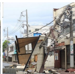
<飛来物による電柱倒壊の事例>
