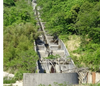
善入寺川 流木流入状況
