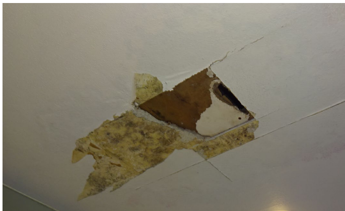
現況写真(漏水)
