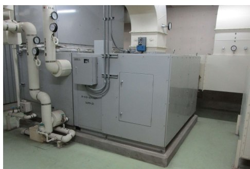
現況写真(機械設備)
