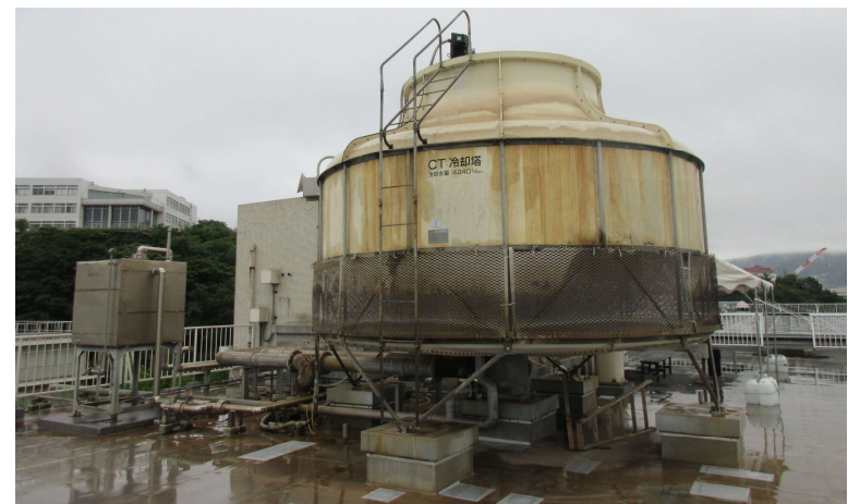
現況写真(冷却塔)
