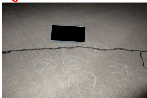
エプロン(駐機場)舗装の老朽化状況
