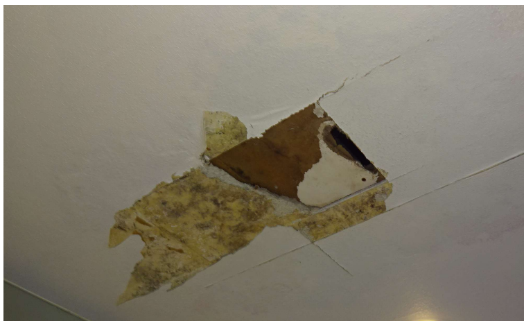
現況写真(漏水)
