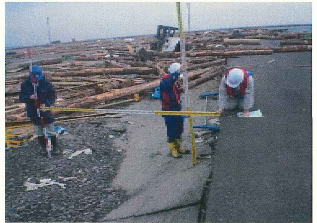
石巻港 被害状況調査(港湾班)
