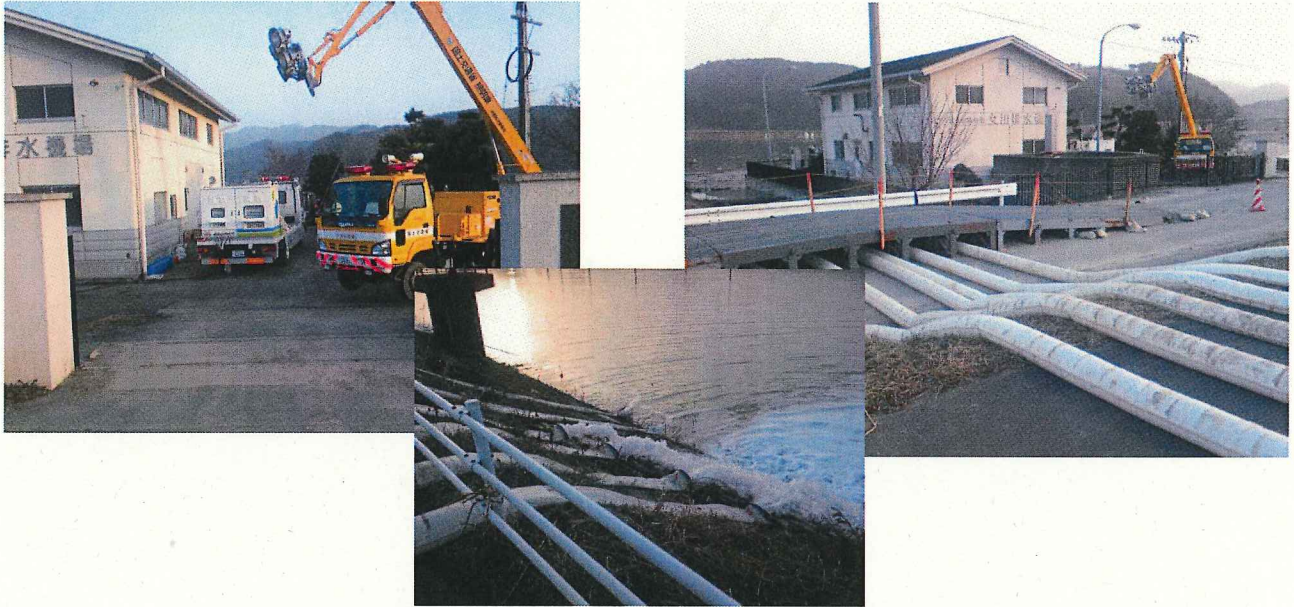
女川排水機場(石巻市)における排水ポンプ車稼働状況
