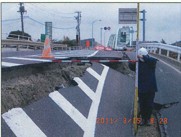
3/14(月) 国道45号被害状況調査 (道路班)
