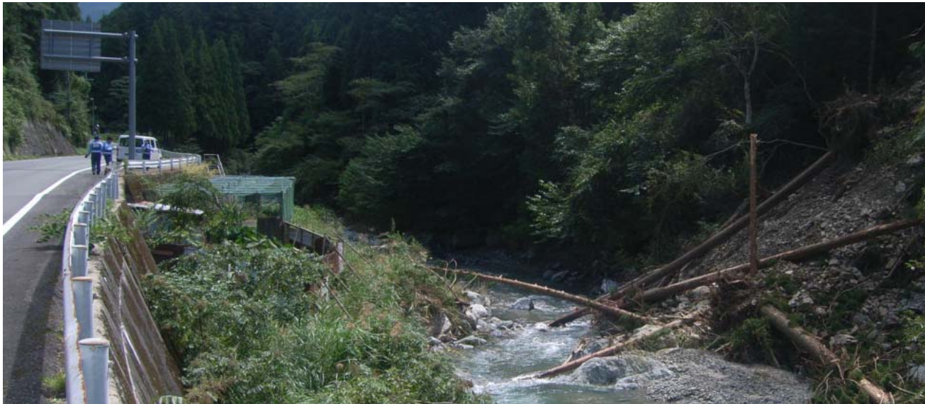
奈良県吉野郡東吉野村 高見川(国道166号沿い)の崩落箇所の被災状況調査
