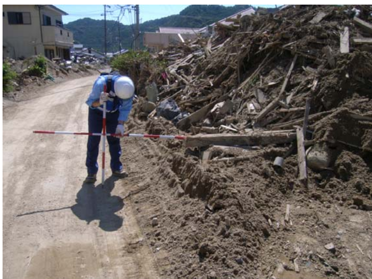
和歌山県那智勝浦町 町道被災状況調査
