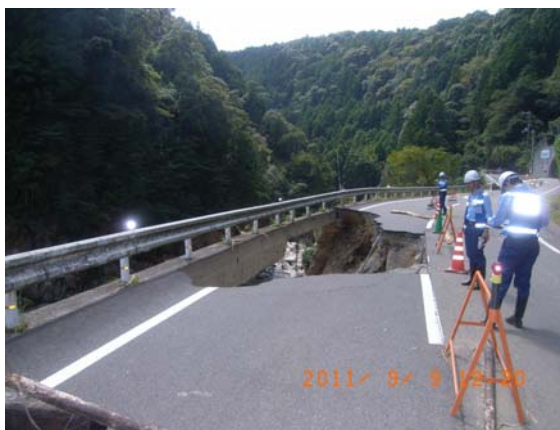
和歌山県新宮市 県道沿いの被災状況調査
