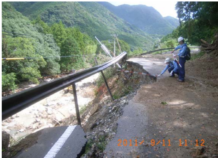
和歌山県那智勝浦町 県道被災状況調査
