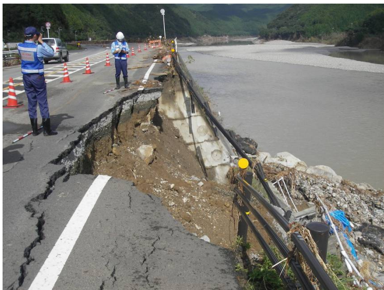
和歌山県新宮市 熊野川沿いの被災状況調査
