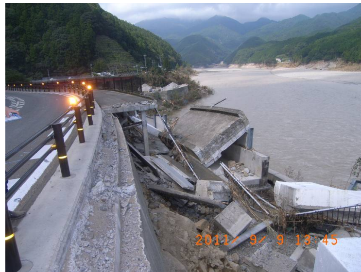
和歌山県新宮市 熊野川沿いの被災状況調査(張出歩道が崩落)
