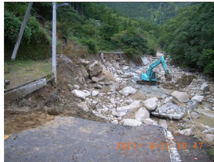
和歌山県那智勝浦町 県道被災状況調査
