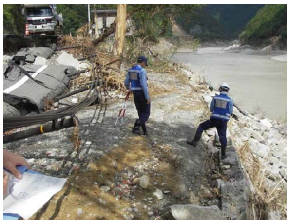
和歌山県新宮市 熊野川沿いの被災状況調査
