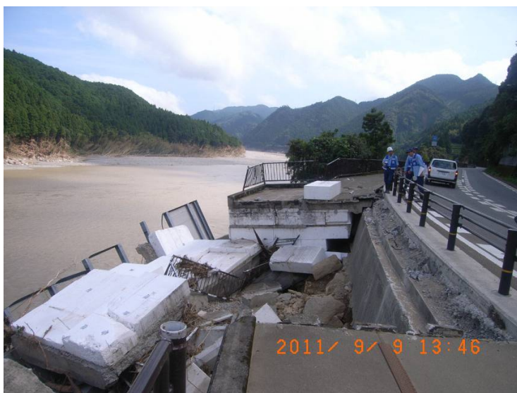
和歌山県新宮市 熊野川沿いの被災状況調査(張出歩道が崩落)
