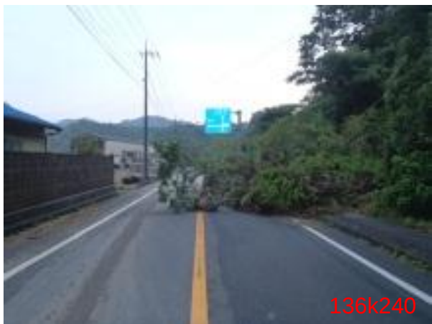
法面崩壊・倒木: 上下線通行止め
