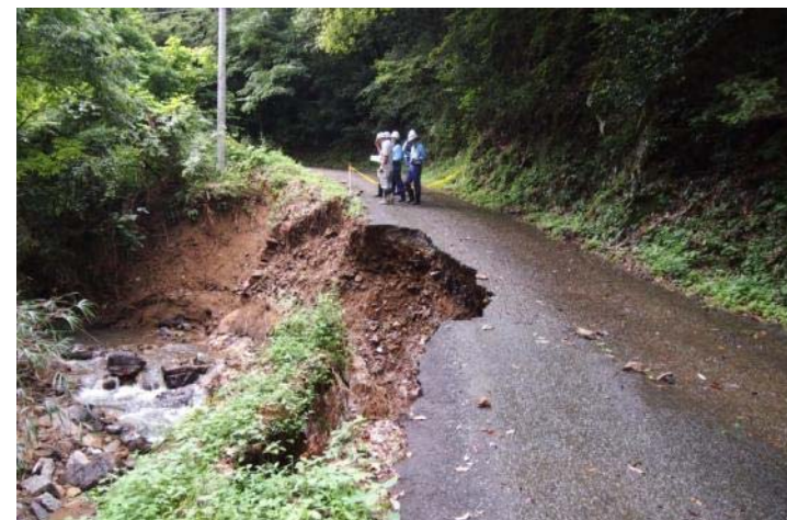
市職員と被災状況箇所の確認
