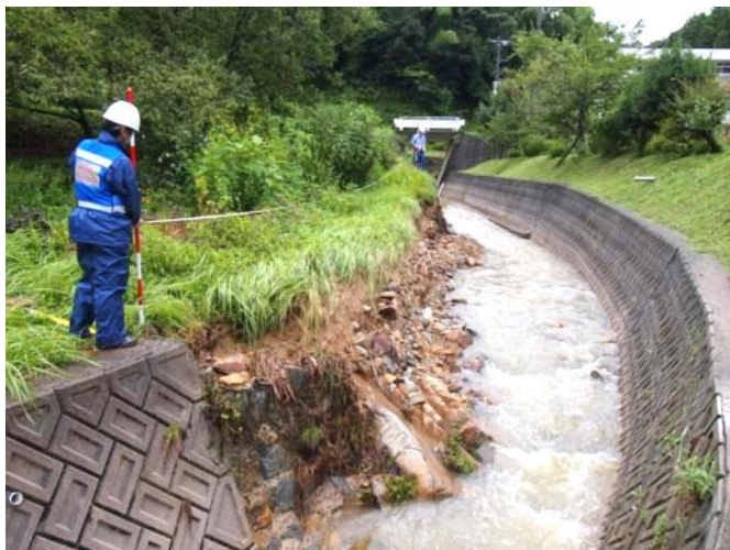
河川班による被災状況調査(湯路川)
