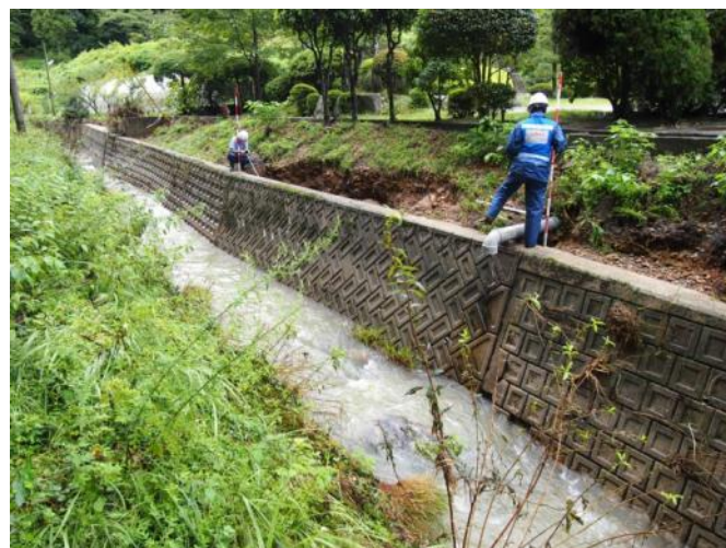
河川班による被災状況調査(湯路川)
