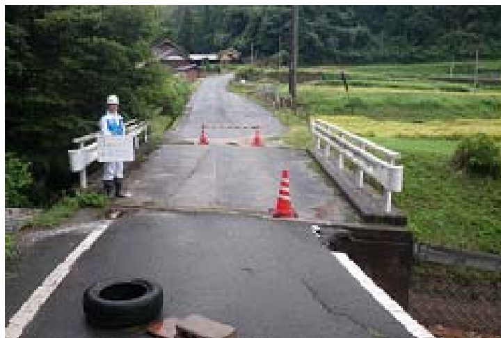
道路班 被災箇所調査(邑南町石見地区)
