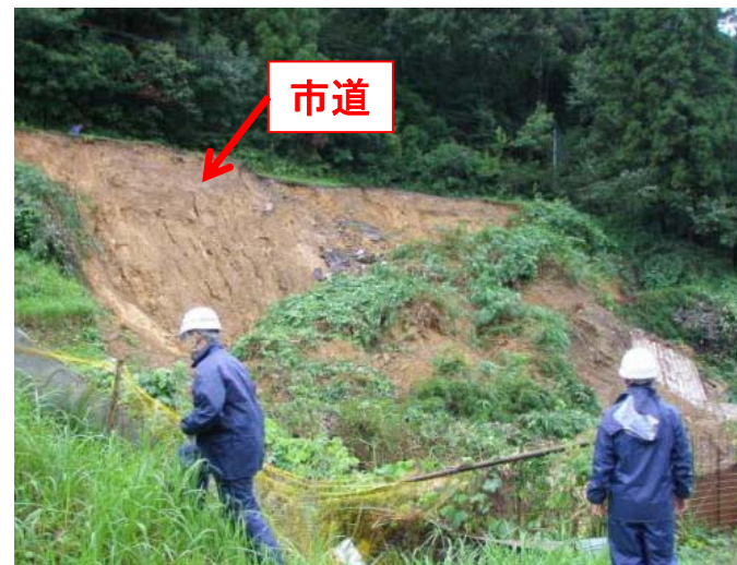
市道被災状況確認(都野津羽代線) 河川2班
