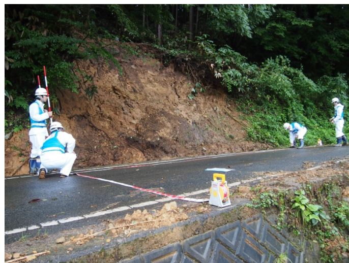
道路班による被災状況調査(町道吉原京羅谷線 )
