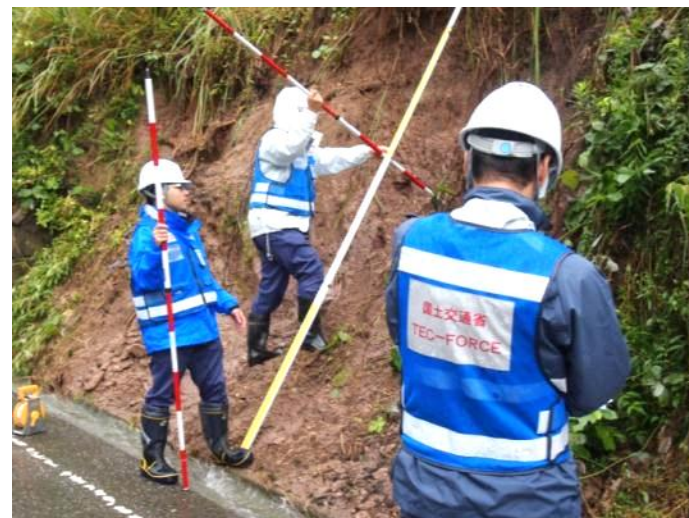
道路班による被災状況調査(町道田代有安線)
