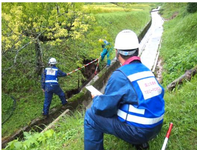
河川班による被災状況調査(落合川支川)
