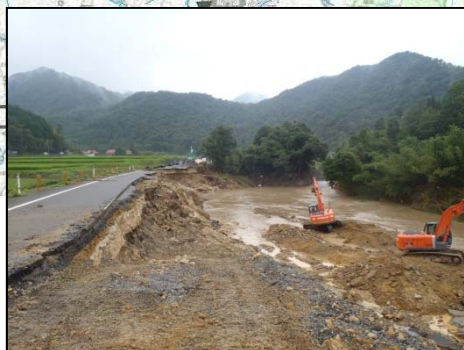
国道315号 被災状況
