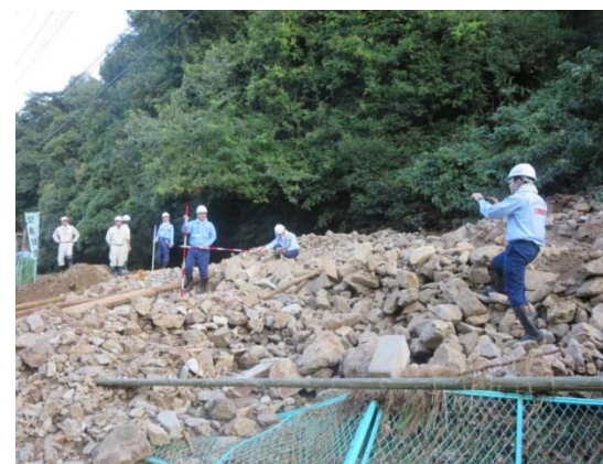
●道路班 被災箇所の事前調査
