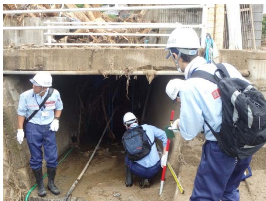
河川班 新建川での被災状況調査
