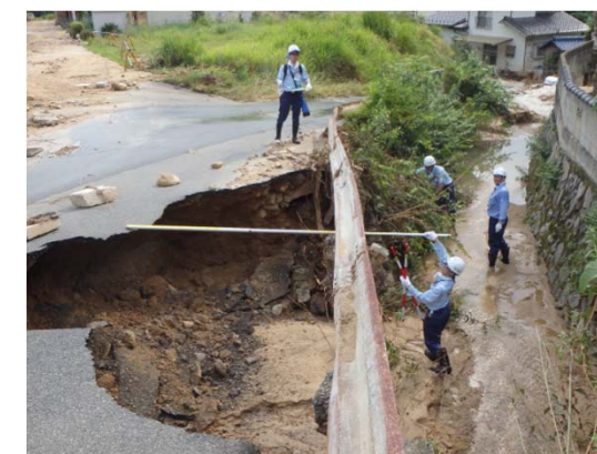
河川班 台川での被災状況調査
