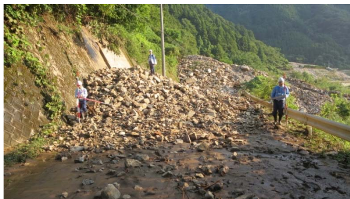
道路班 一般県道下佐東線被災状況調査
