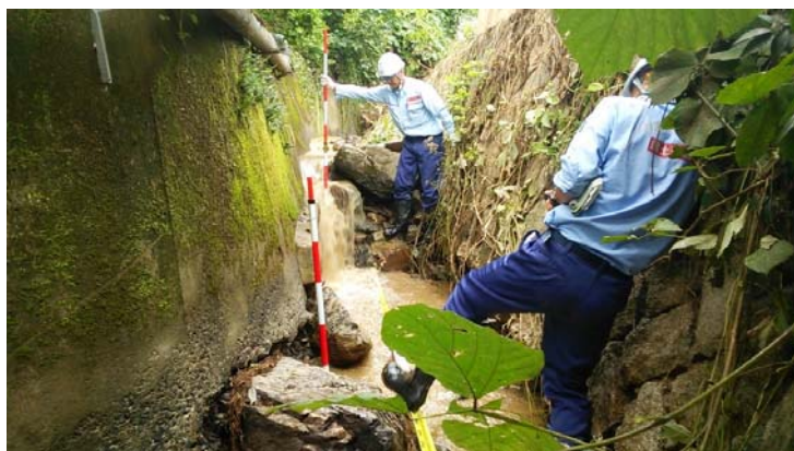
被災状況調査(山手川 安佐南区八木4丁目)
