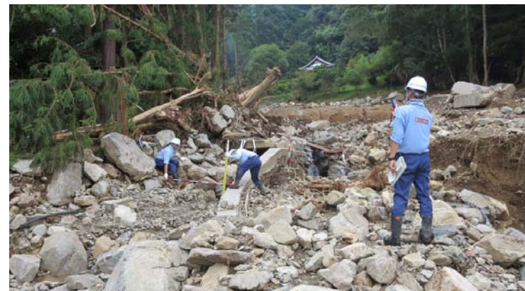
被災状況調査(山手川 安佐南区八木4丁目)
