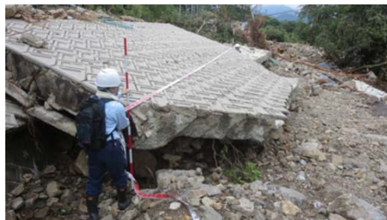
被災状況の調査（道路班） 【H26.8広島豪雨災害】
