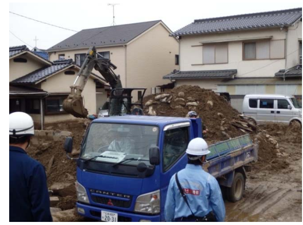
堆積土砂の撤去状況（道路） 【安佐南区八木】
