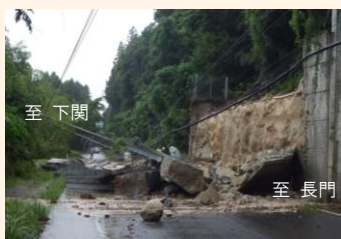
下関長門線の土砂災害
