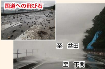
国道191号の越波状況
