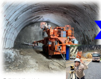
①長門市俵山地区内 工事名：第1トンネル工事(別紙-1参照)
