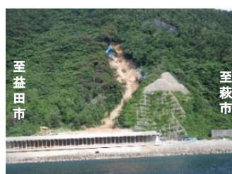
【写真③】H23年土砂崩壊の状況
