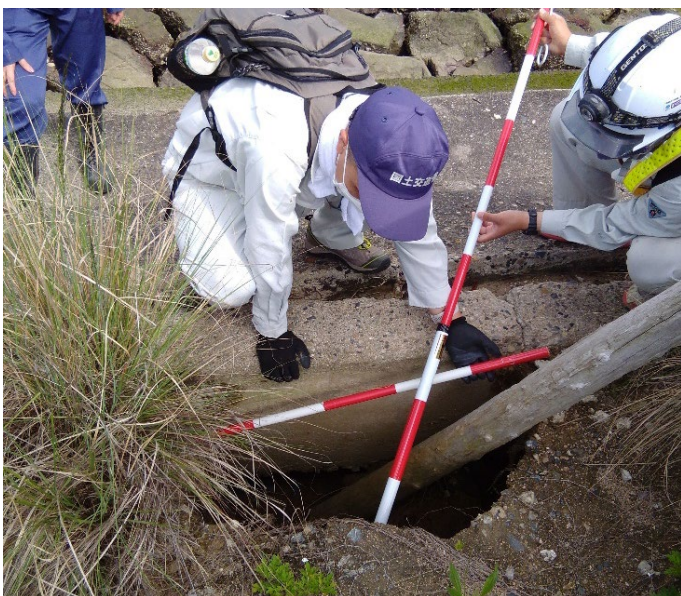
護岸付近の陥没状況(高梁川)
