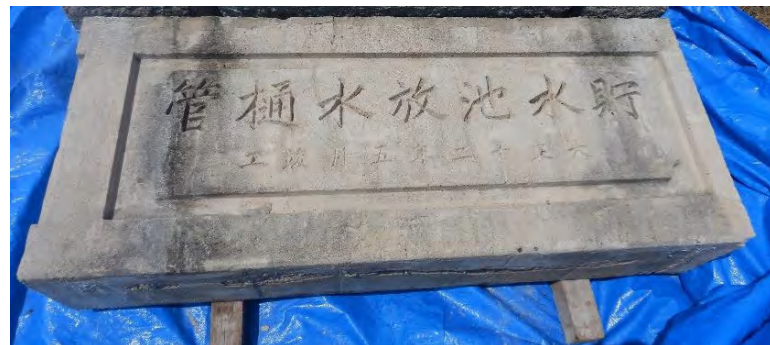
【銘板の切断状況：放水樋管】
