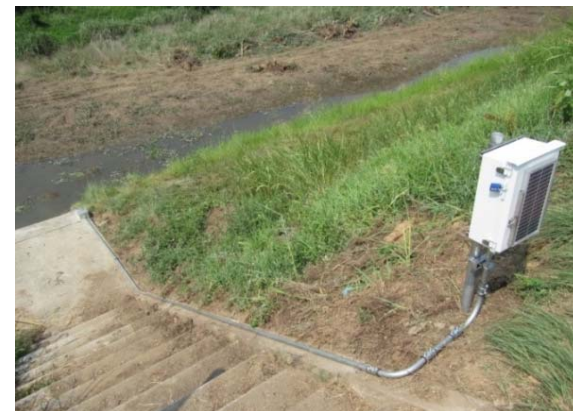
危機管理型水位計の設置状況 (小田川右岸 矢形橋付近)
