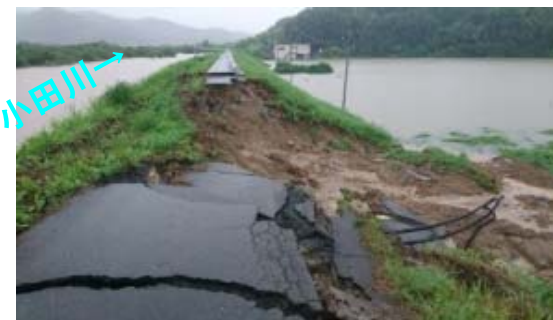
法崩れの発生状況
