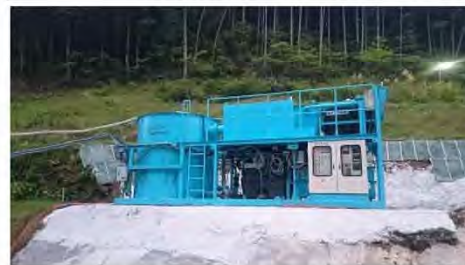
濁水処理施設（例）
