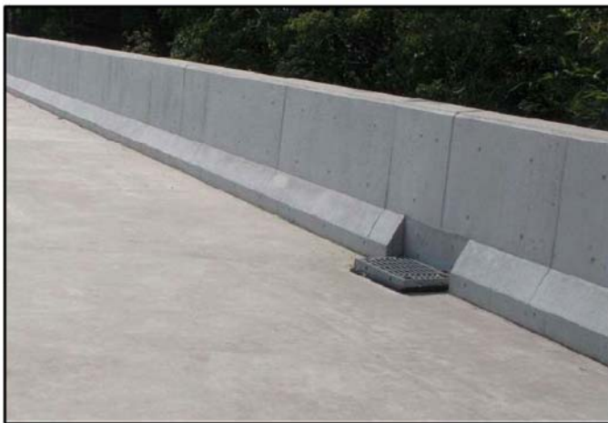
壁高欄排水柵の望ましくない位置の例
