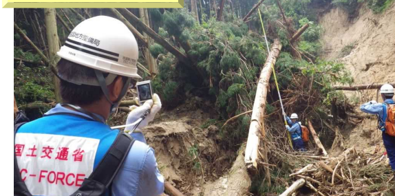
【H26.8 広島土砂災害】 (広島県広島市)
