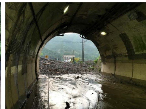
土砂流出状況(トンネル内部より)
