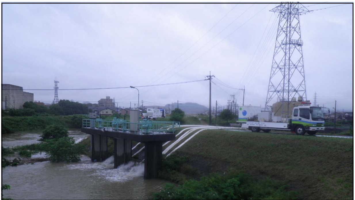
平成30年7月7日 清水川排水機場付近における排水作業状況 (鳥取県鳥取市吉成南地先)
