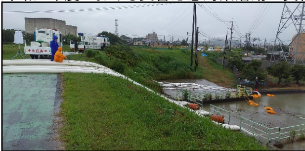
令和3年7月豪雨号対応 排水ポンプ車による排水作業(鳥取市吉成南町)
