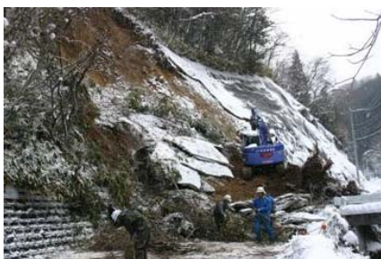
【写真②】平成17年1月法面崩壊 (国道183号庄原市西城町)
