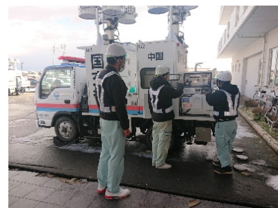
停電施設で、照明車に搭載された発電機から電力供給を行っています。
