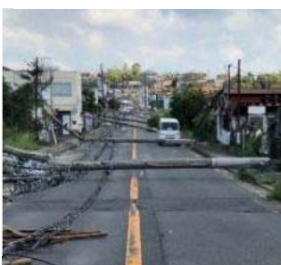
<電柱の倒壊による道路閉塞の事例>
