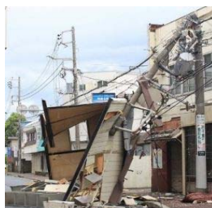
<飛来物による電柱倒壊の事例>
