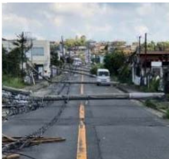
<電柱の倒壊による道路閉塞の事例>
