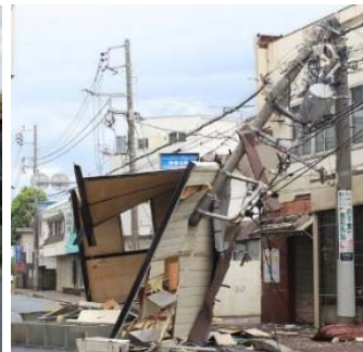
<飛来物による電柱倒壊の事例>
