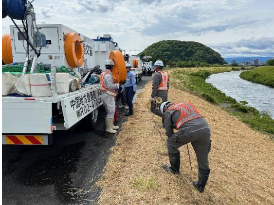
【排水ポンプ車訓練状況】
