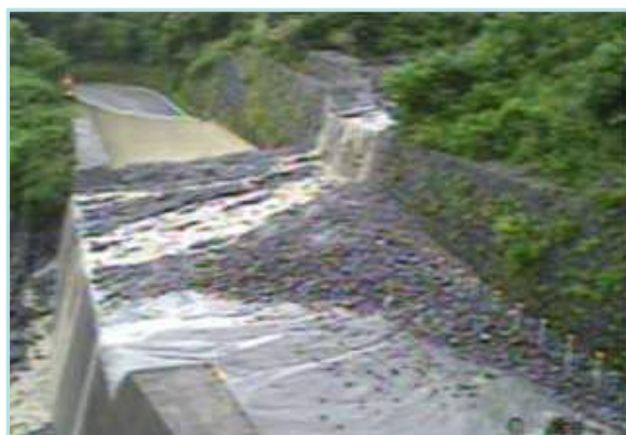
大山環状道路への土砂流出状況
