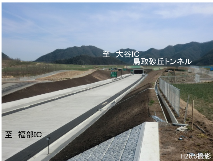
【写真①】鳥取市福部町海士地区(鳥取砂丘トンネル付近)
