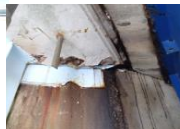
床版の剥離・鉄筋露出状況
