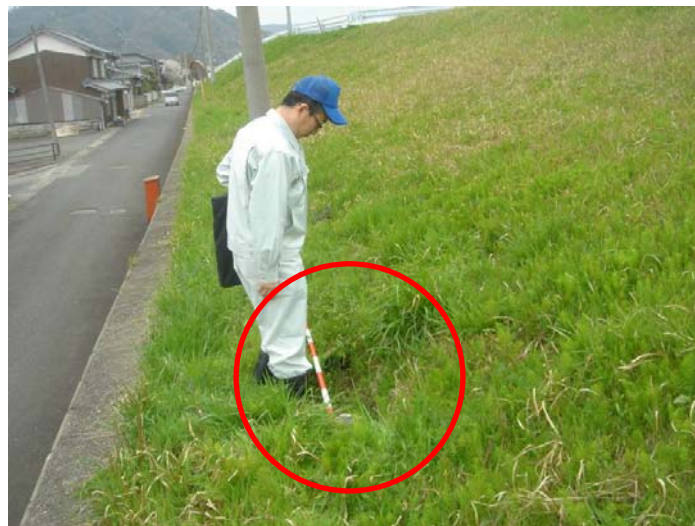
千代川 堤防に陥没 (出水期までに補修)
