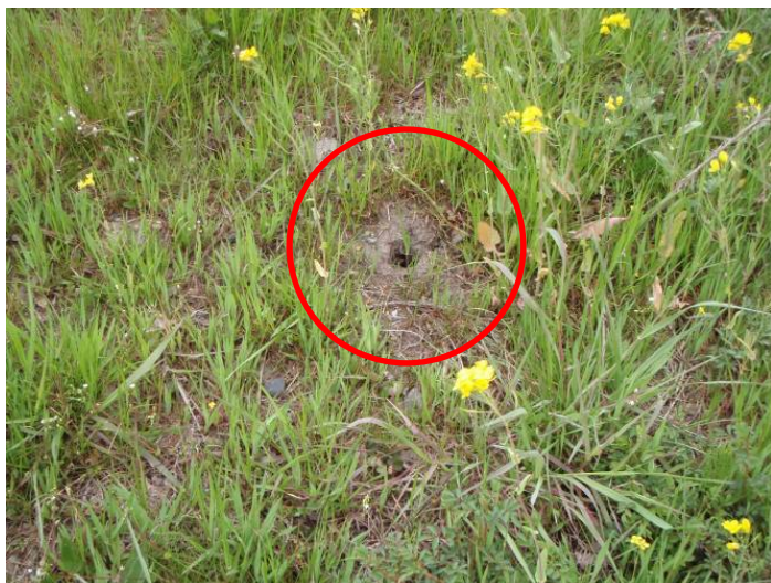
千代川 堤防にモグラなど小動物の穴 (出水期までに補修)
