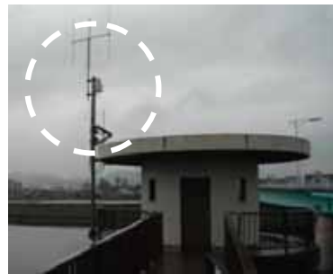
図 4.19 行徳水位観測所の警告灯
