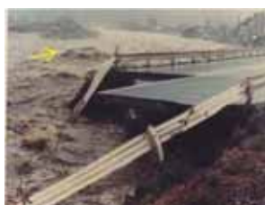
昭和 54 年 10 月洪水 侵食された道路 (安蔵付近)
