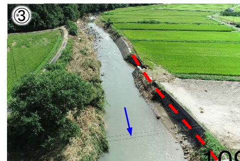
▲護岸崩壊の状況
