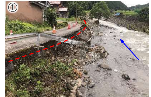
▲護岸崩壊の状況
