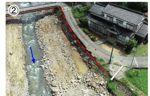
▲護岸崩壊の状況
