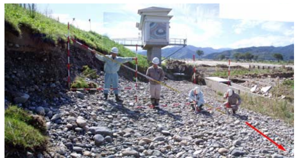
平成 16 年 9 月洪水による堤防の崩壊状況(倉田スポーツ広場付近)
