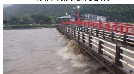
平成30年7月7日豪雨(梅雨前線) 増水状況(用瀬町中橋付近)
