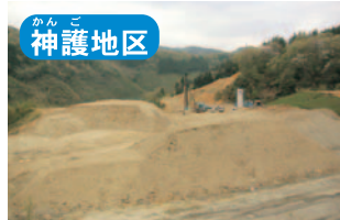
かんご地区 殿ダム 原石山進入路(その2)工事 ダム本体の材料となる石(骨材)を採取するための進入路を造ります。
