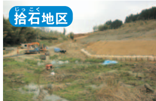
しっこく地区 殿ダム 拾石地区県道付替(その7)工事 県道(拾石地区)の付替工事です。
