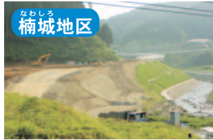
楠城地区 殿ダム 楠城地区県道付替工事 県道(楠城地区)の付替工事です。
