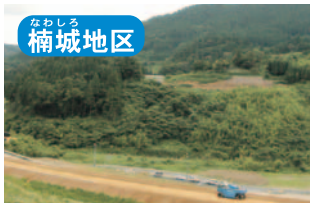
楠城地区 殿ダム 楠城山崎線付替(その2)工事 付替市道(楠城地区)の付替工事です。
