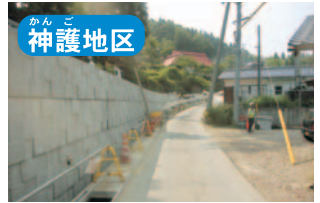
神護地区 殿ダム 神護地区取付工事 付替市道(神護地区)の取付工事です。
