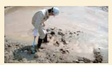
簡易沈砂池にたまった泥土
