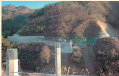
C 山崎集落と楠城集落を結ぶ道路(楠城山崎線)を造っています。また、この道路と付替県道を結ぶ貯水池横断橋(仮称)の橋をのせるための台(橋台)と橋脚2基が完成しました。(撮影:平成20年12月)
