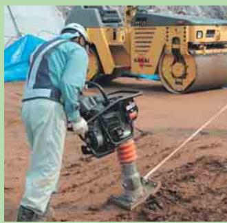
⑩ ランマーで締固める 施工場所の端部は、ランマーを使い、人力で締固めます。
