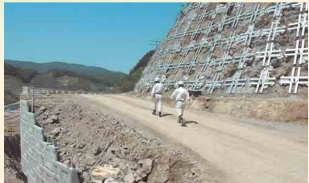
D 法面の補強や補強土壁の施工途中の様子 (撮影:平成 21年6月)
