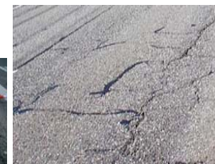
舗装のひび割れ
