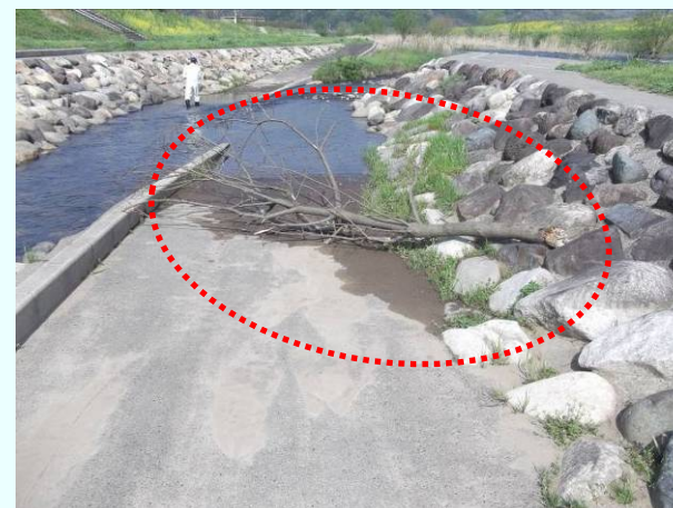
【新袋川・袋川】 スロープに流木 (安全利用点検:宮ノ下水辺公園)
