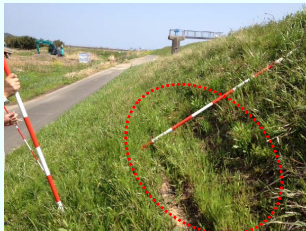
【千代川】 堤防法面の侵食 (堤防点検)
