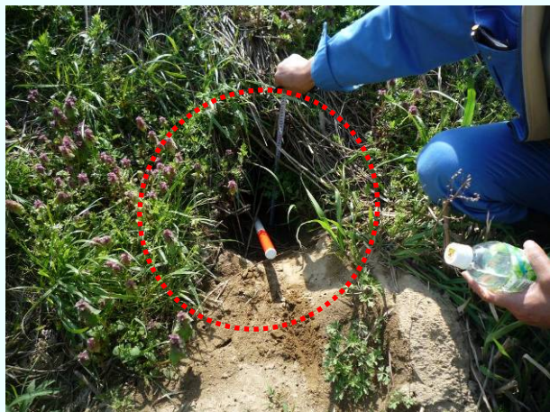
【千代川】 堤防法面に小動物の穴 (堤防点検)
