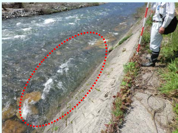
【千代川】 根固め(捨石)の流出 (堤防点検)
